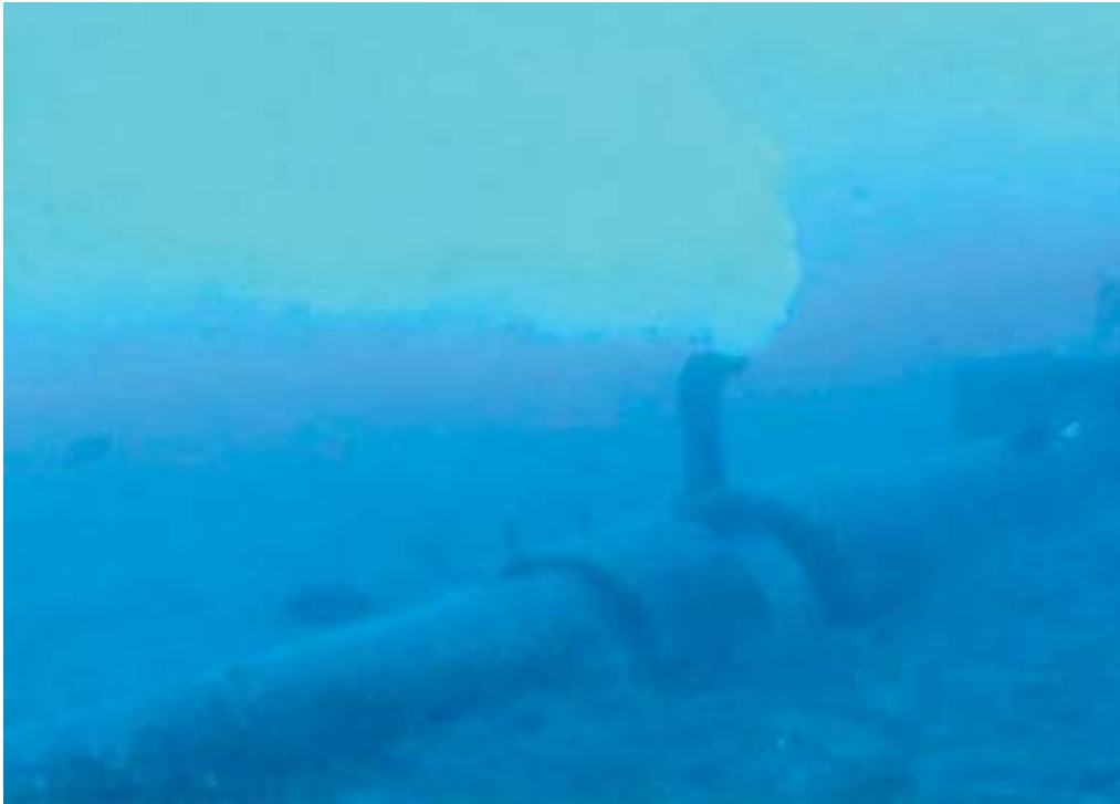
SUBSANAR Y AMPLIAR EL EMISARIO SUBMARINO ES AHORA MISMO LA MÁXIMA PREOCUPACIÓN DE LAS ADMINISTRACIONES. DA
